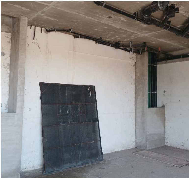
Imagen B' Ref.: Vista sala de máquinas primer piso - Enero 2025
