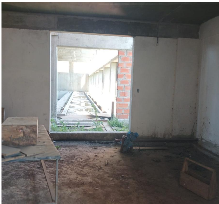
Imagen V. Ref.: Vista Sala de máquinas, orientación hacia piscina. - Enero 2025
