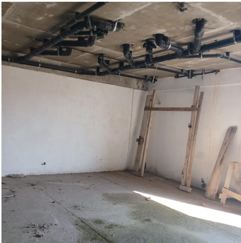
Imagen C' Ref.: Vista sala de máquinas primer piso - Enero 2025
