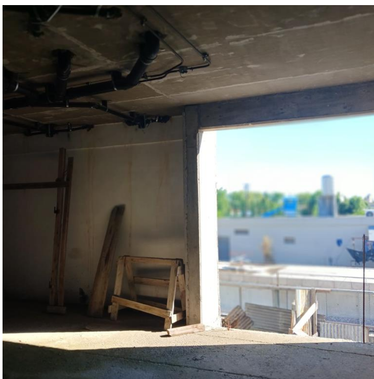
Imagen A' Ref.: Vista sala de máquinas primer piso orientación hacia vías. - Enero 2025
